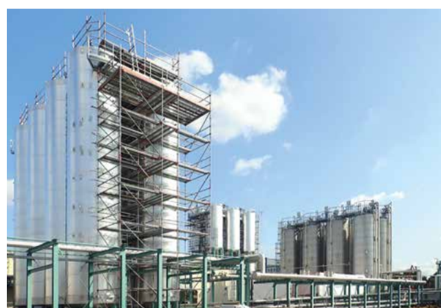
Im Vordergrund: Alle acht Blending-Tanks wurden aufgestellt. Bis zur ersten Mischung im Oktober 2019 müssen unter anderem noch Rohrleitungen und Elektrotechnik verlegt werden.
